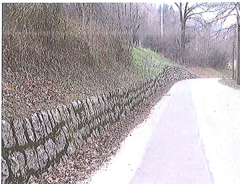
Dingy-OG1 : Les Moreennes, route menant à Jurens – Mur de pierres maçonnées confortant la base du talus.
